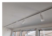
▲ライティングレール
