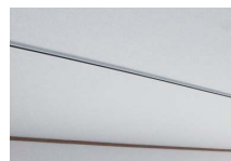
▲ライティングレール
